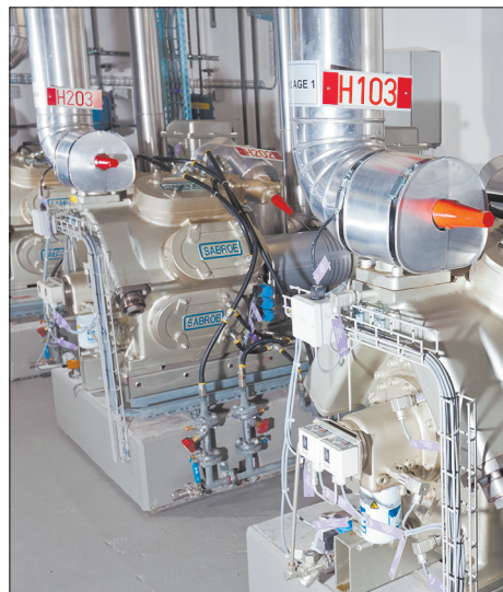
WÄRME FÜR 12 000 MENSCHEN: Blick in die Verdichtungs Motoren im Maschinenraum.
