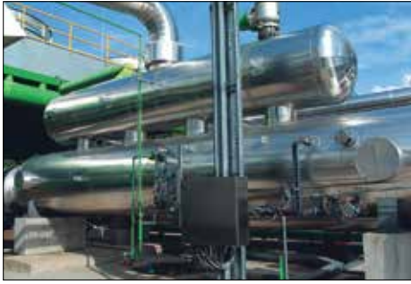
TECHNIK. Wärmetauscher für Verstromung
