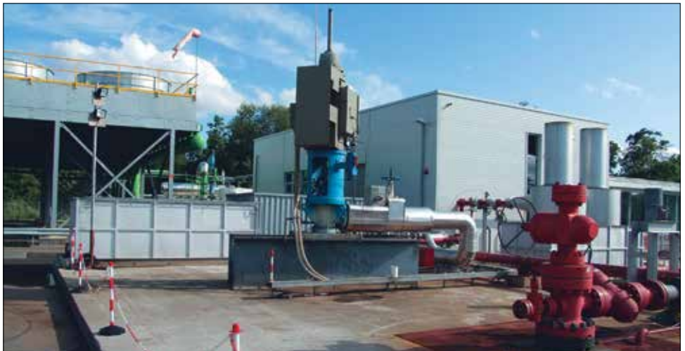
TATBEWEIS. Das Geothermie-Kraftwerk Insheim liefert zuverlässig Strom und Wärme.
